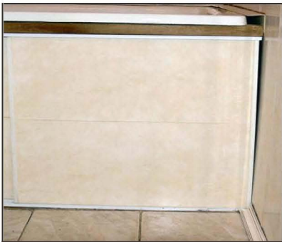
Дверки усилены отрезками короба для наружной электропроводки, надетыми со стороны торцов панелей.
