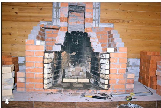
4 Заднюю стенку топочной камеры в процессе реконструкции выдвинул вперёд на 3/4 кирпича. Вся новую кладку топочной камеры вёл шамотным кирпичом.
