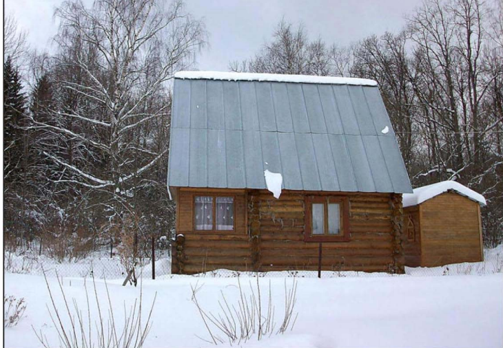
В зимнее время сползающий с крыши снег дополнительно укрывает цоколь, но весной, когда снег тает, деревянные стены отсыревают на большую высоту.
