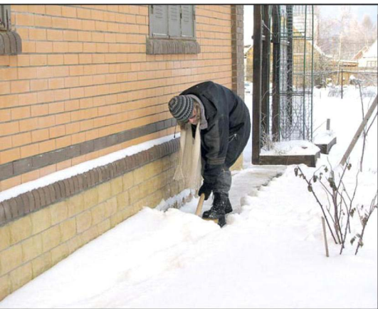
Расчистка отмостки и оголение цоколя — обязательное мероприятие при посещении загородного участка в зимний период.
